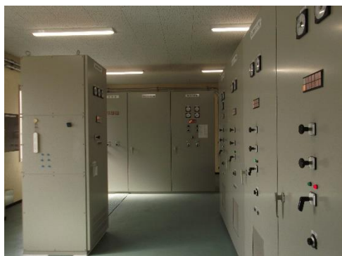
【制御設備・計装設備】
