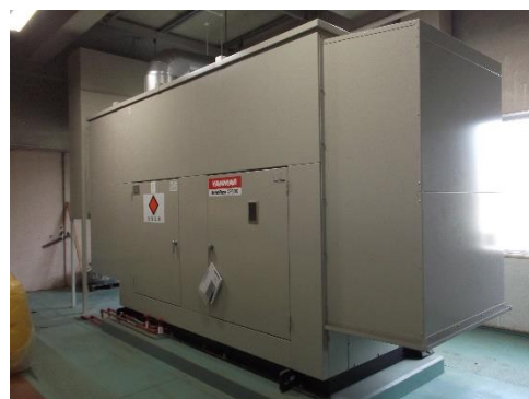
【非常用発電機】
