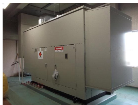
【非常用発電機】
