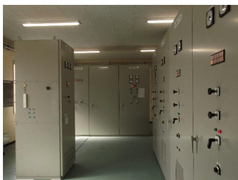
【制御設備・計装設備】
