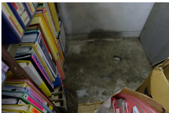
本庁舎裏書庫雨漏り跡
