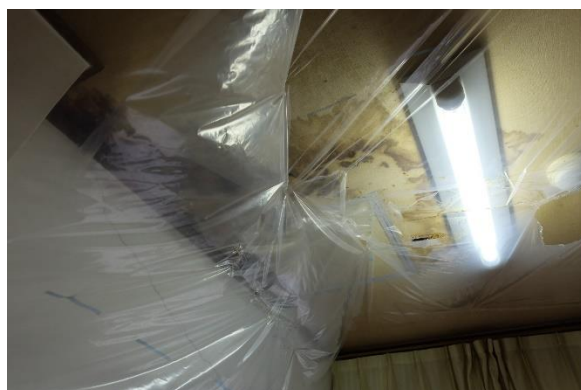
議会録音室雨漏り跡
