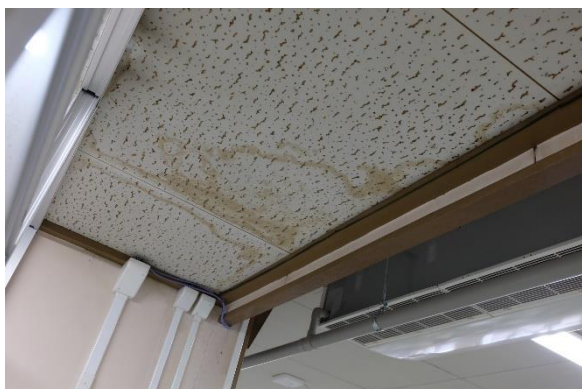
本庁舎1F 雨漏り跡
