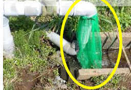
給水栓に収穫ネットの取り付け例
