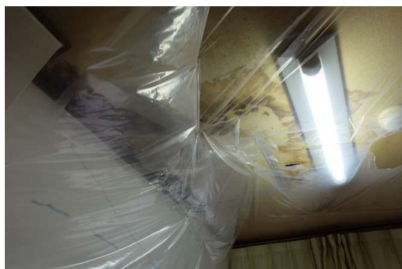
議会録音室雨漏り跡
