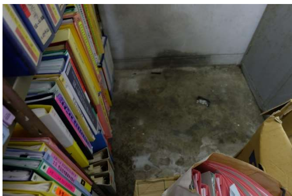
本庁舎裏書庫雨漏り跡
