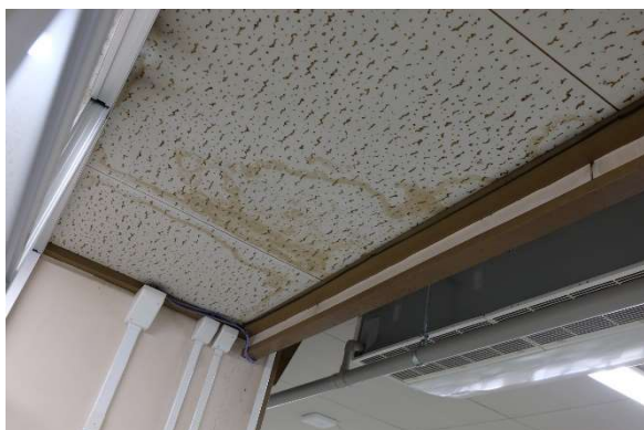
本庁舎1F 雨漏り跡
