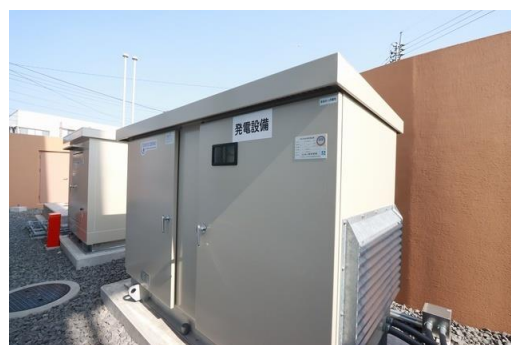
昭和村：3日間電力を供給する非常用発電機
