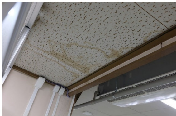
本庁舎1階雨漏り跡
