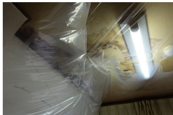
議会録音室雨漏り跡
